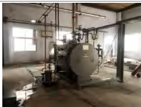
现有工程蒸汽锅炉
