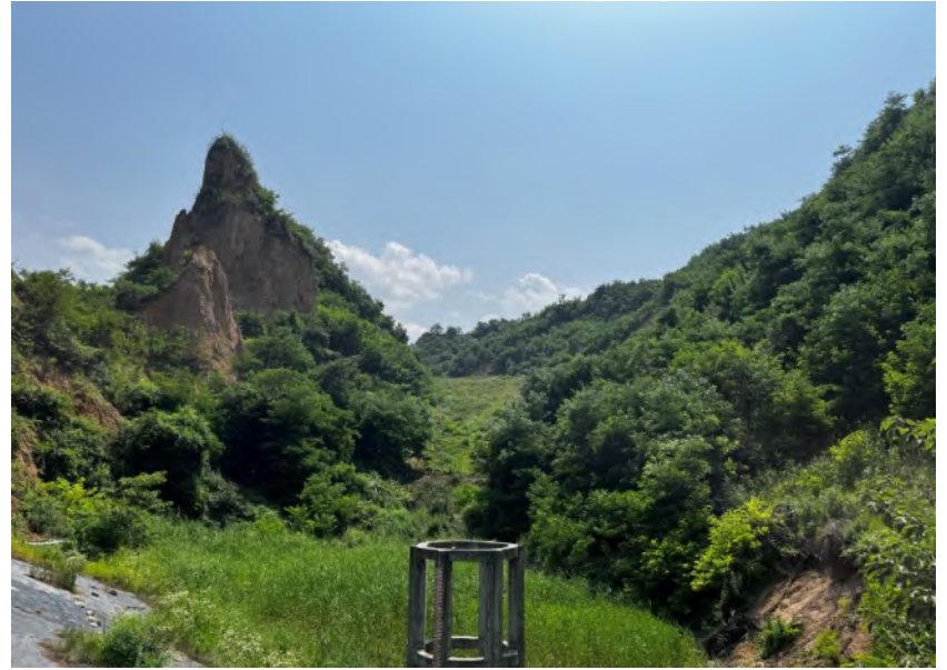
尾矿库溢流井
